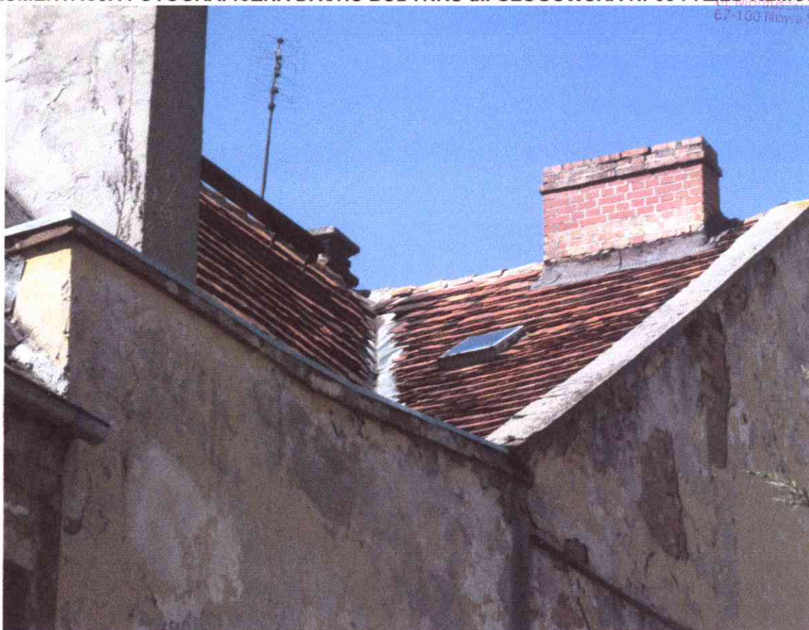
FRAGMENT DACHU BUDYNKU ul. GŁOGOWSKA Nr 38 OD STRONY PÓŁNOCNEJ –WIDOK KOSZA ŚCIEKOWEGO
